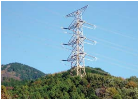
○10YR6.0/1.0の色彩を使用し、景観配慮された高圧線鉄塔
