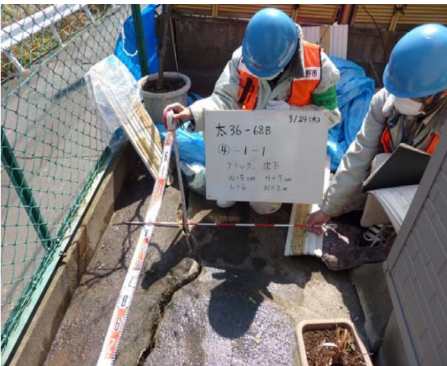
犬走りコンクリートの亀裂の状況
