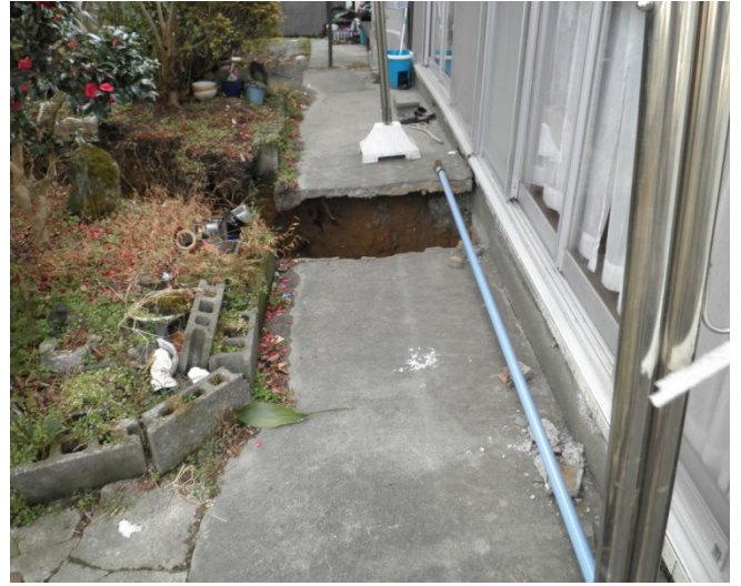
宅地内の地盤の陥没
