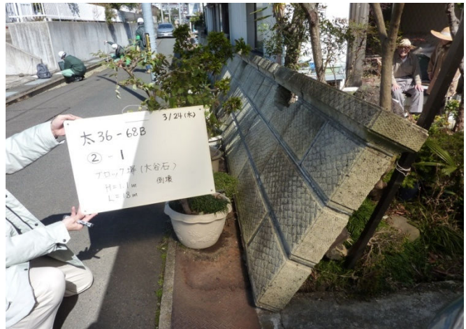
ブロック塀の転倒の状況
