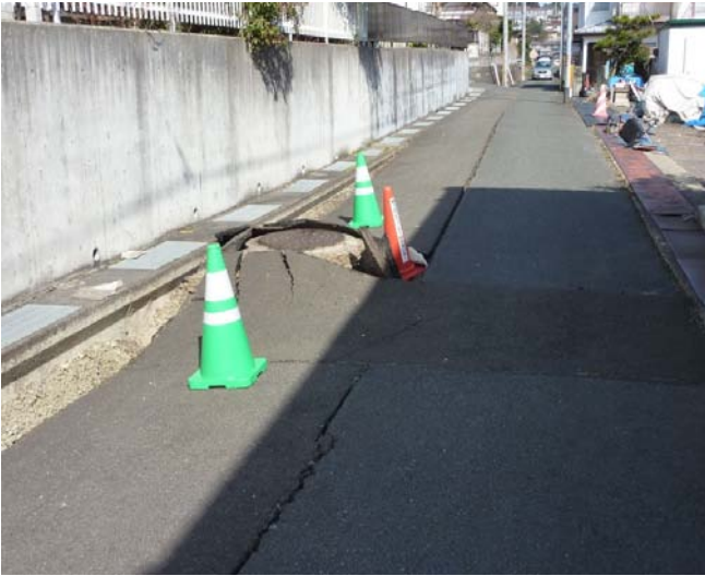
道路陥没によるマンホール突出の状況
