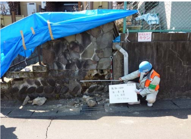
玉石積み擁壁の崩壊の状況
