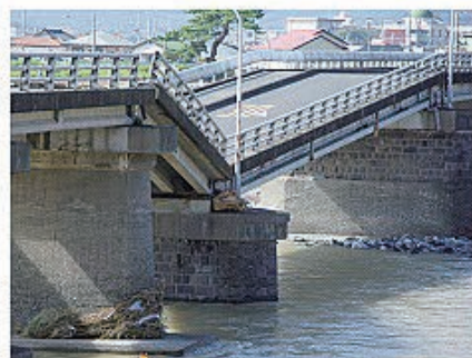
防災・減災への対応 (落橋防止対策等)
