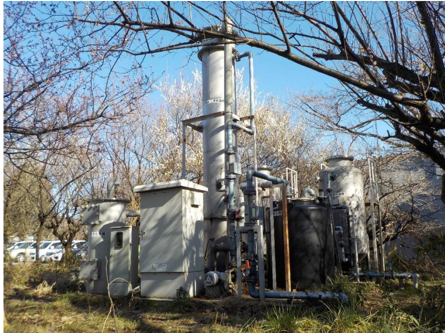
図 4-17 地下水浄化装置
