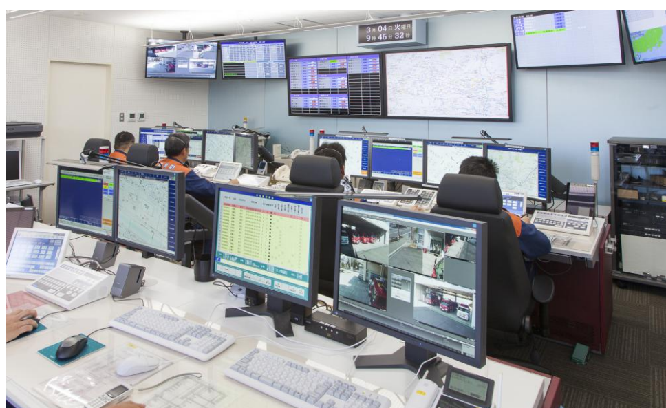
平成26年3月1日に更新した通信指令システム
