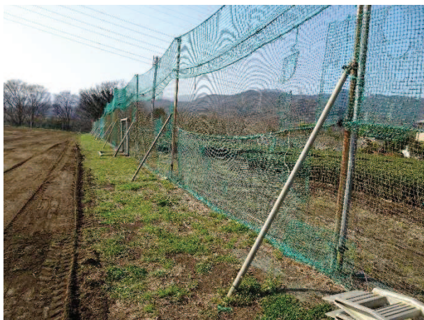
高さが不足している防球ネット
