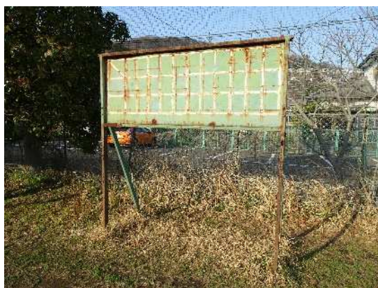
老朽化したスコアボード
