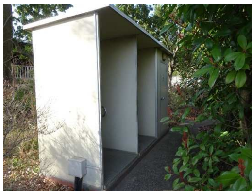
老朽化が進むトイレ
