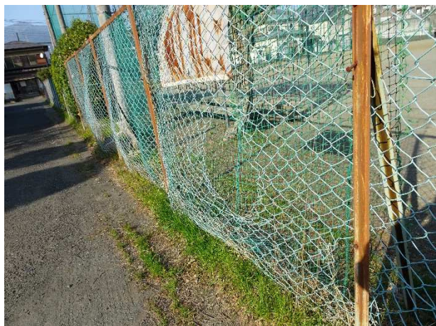
ネットフェンスの老朽化
