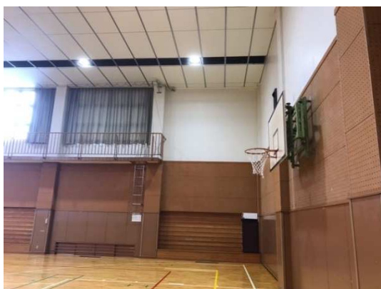
カーテンレールの老朽化
