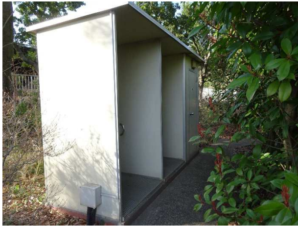
老朽化が進むトイレ
