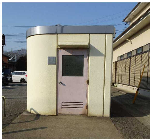
雨漏りのあるトイレ
