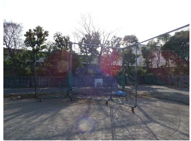
老朽化が進むバックネット
