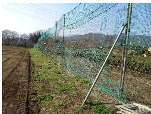
高さが不足している防球ネット
