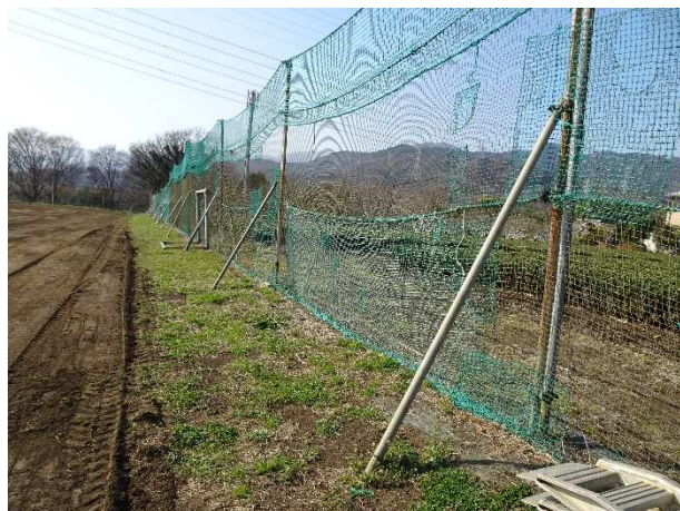
高さが不足している防球ネット
