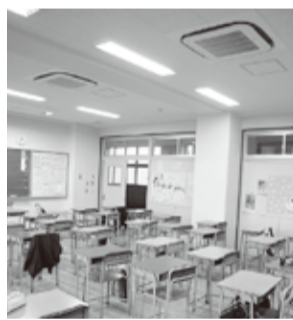
本町中学校に設置された空調設備
