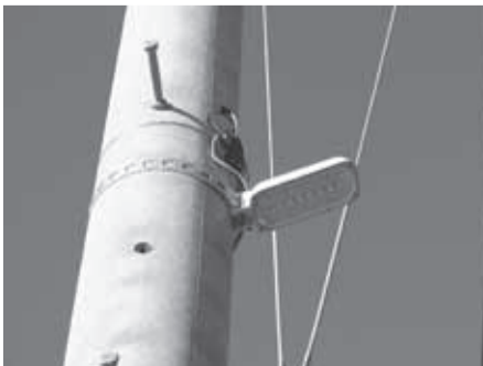
LED化された防犯灯
