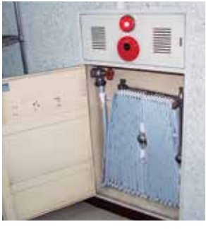
人命確保に必要な消防設備の設置を(写真は屋内消火栓)
