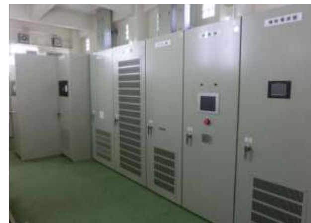
上原変電所 回生電力貯蔵装置
