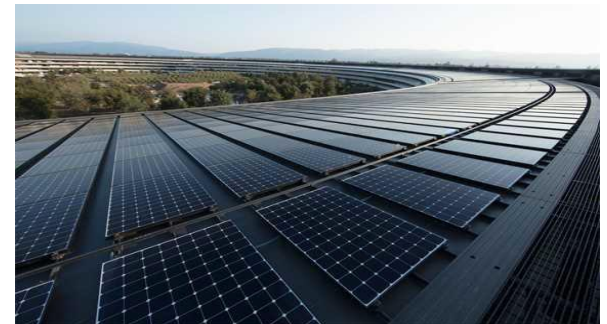
Apple新本社の屋上太陽光 (米・クパティーン)
