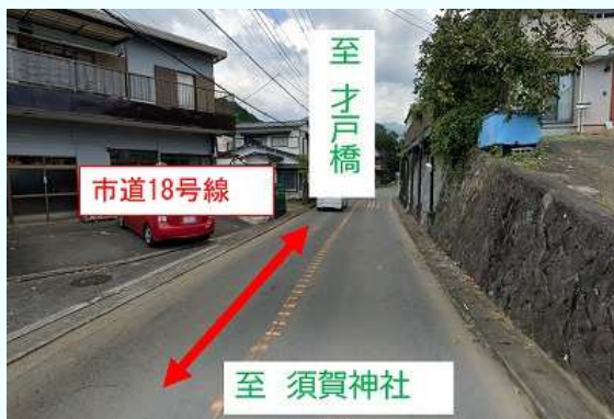
側溝の蓋の穴や段差で歩行しづらく、危険
