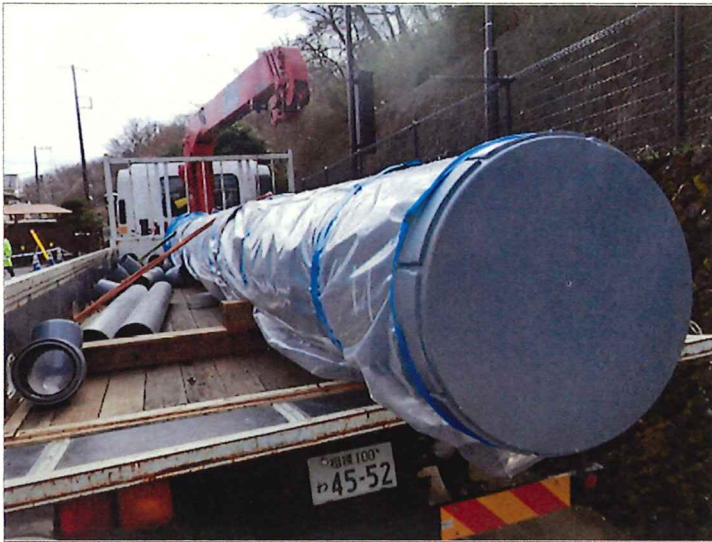
ダクタイル鋳鉄管 NS形 φ500mm ポリエチレンスリーブ で被覆されている
