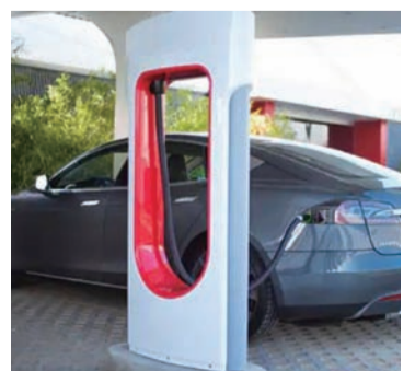
高出力の急速充電設備
