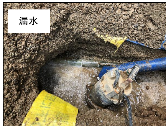
図 4-10 給水管の漏水
