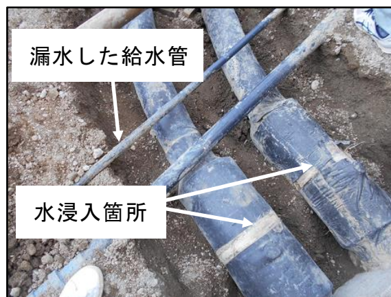
図 4-11 給水管と高温水配管
