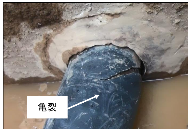
図 3-4 高温水配管外皮の亀裂
