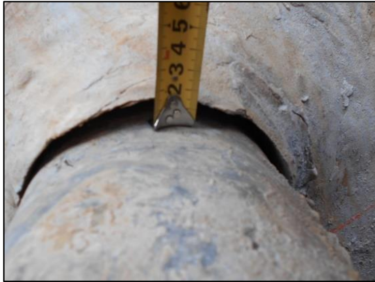
図 4-1 貫通孔と高温水配管の空隙 (クリーンセンターボックスカルバート外側)
