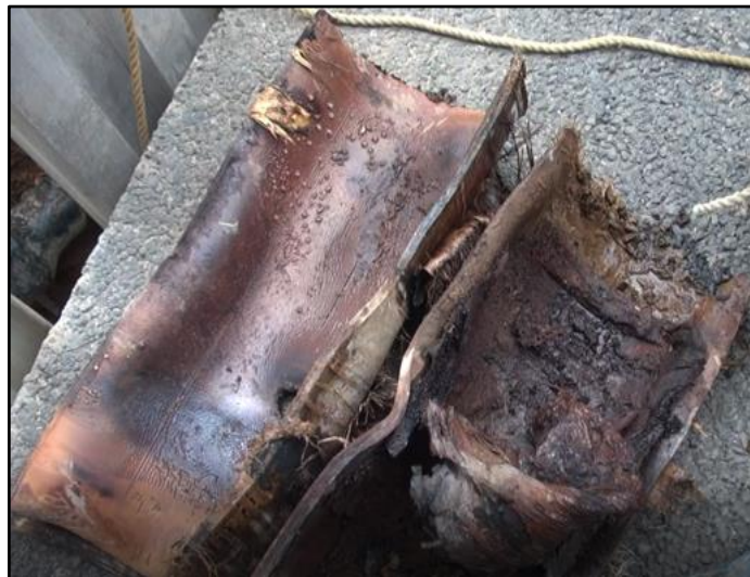
図 4-9 高温水配管保温材劣化の状態
