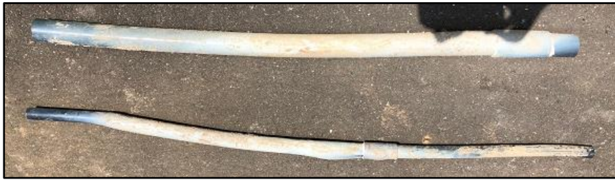
図 3-6 給水管の変形、破損
