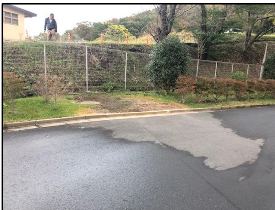
図 2-2 高温水配管の影響により乾いた路面状態 (クリーンセンター敷地内)
