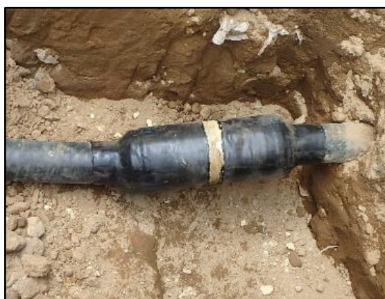
図 4-3 富士見の湯側土中埋設部分の溶接箇所 ラップしろが確保されていない状態 (クリーンセンター建設に伴う利便施設新築工事・施工中)
