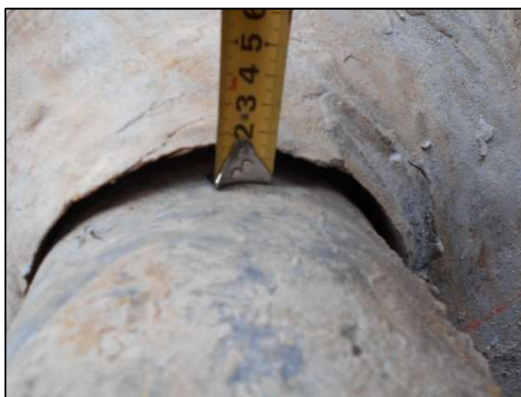
図 4-1 貫通孔と高温水配管の空隙 (クリーンセンターボックスカルバート外側)
