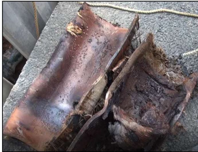
図 4-10 高温水配管保温材劣化の状態
