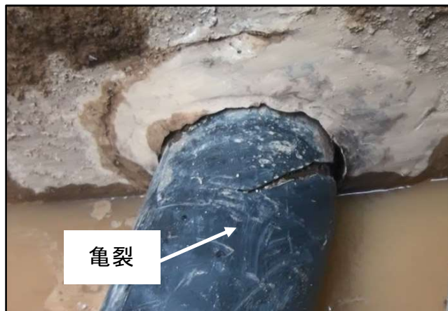
図 3-5 高温水配管外皮の亀裂
