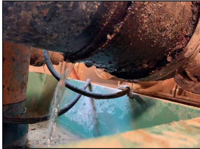
図 4-13 ボックスカルバート内に水道水が流入
