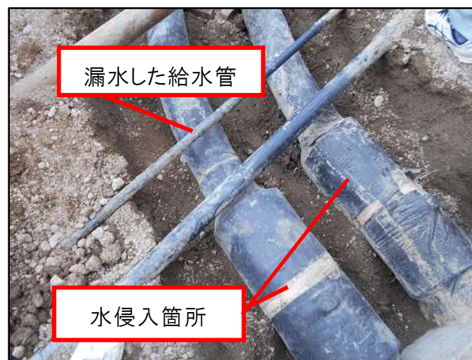
図 4-12 給水管と高温水配管（クリーンセンター敷地内）
