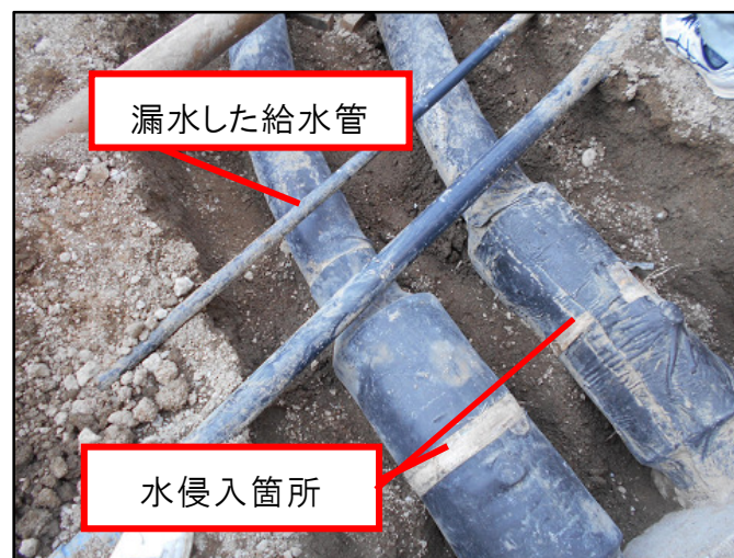
図 4-11 給水管と高温水配管（クリーンセンター敷地内）
