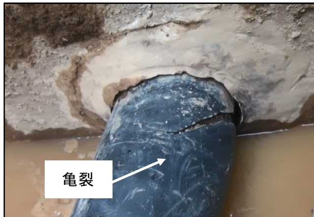
図 3-5 高温水配管外皮の亀裂
