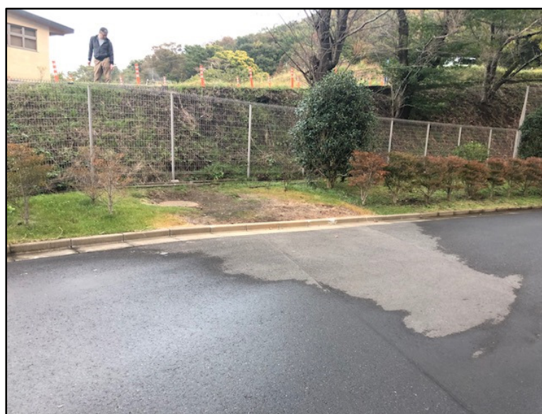
図 2-1 高温水配管の影響により乾いた路面状態 (クリーンセンター敷地内)
