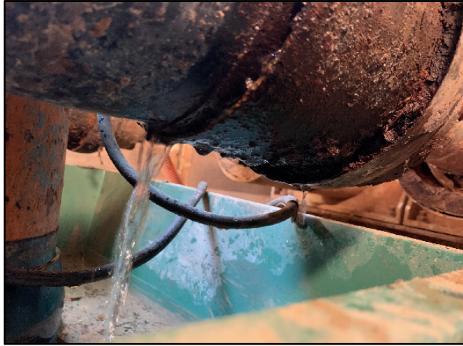
図 4-12 ボックスカルパート内に水道水が流入
