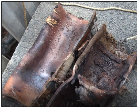
図 4-9 高温水配管保温材劣化の状態
