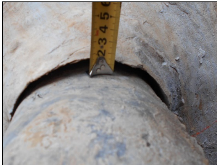
図 4-1 貫通部と高温水配管の空隙 (クリーンセンターボックスカルバート外側)
